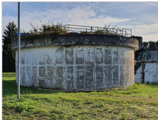
Photo 5 : Cuves de la station d'épuration, © Rainette, 2022
